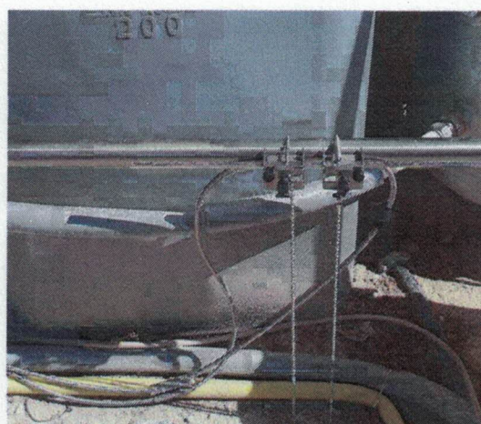
Dettaglio del misuratore di portata ad ultrasuoni montato sul tubo di mandata del collettore in prova
